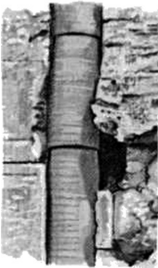
Tubería de desagüe, de material cerámico, encajada a la pared de una casa, tal y como puede verse hoy en la ciudad de Pompeya.
